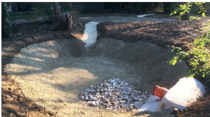
Retenční nádrže pro dešťové vody z ulice Dvorní (studie z roku 2012)
