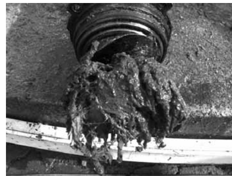
Mechanická část čerpadla vytaženého na čerpací stanici Ploštiny.
