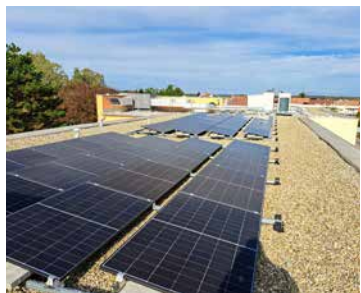
Fotovoltaická elektrárna na budově MŠ
